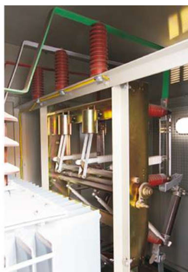
Figura 21. Implementación de un nuevo banco de condensadores
