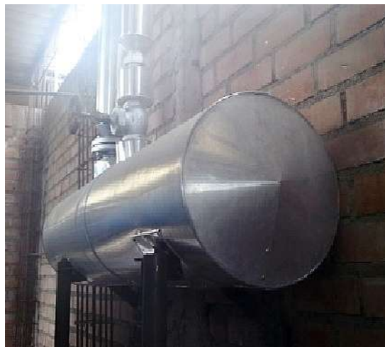
Figura 31. Después de la implementación: Manifold y redes de distribución con aislamiento térmico
