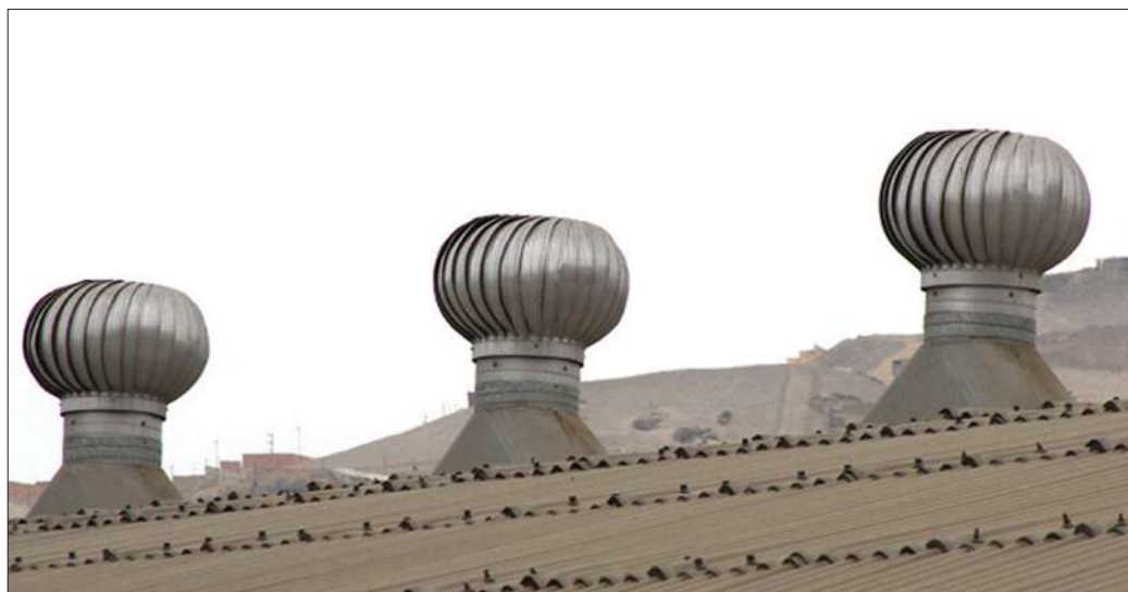
Figura 28. Extractores eólicos instalados en la planta
