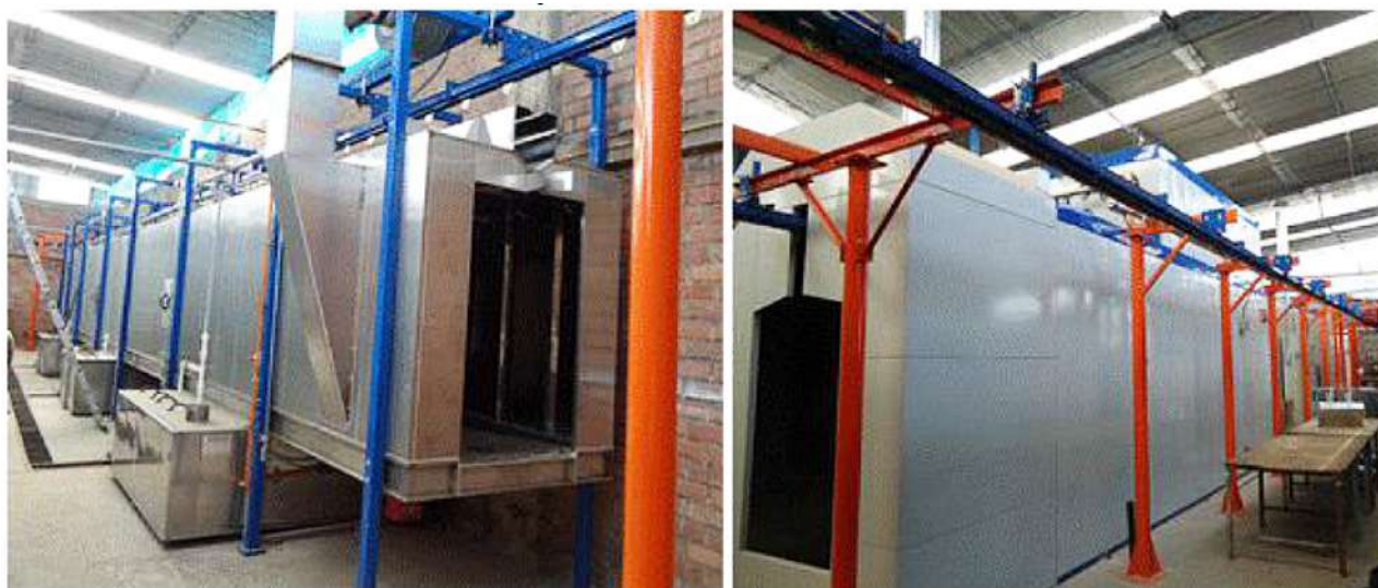
Figura 33. Sistema de pintura en línea
