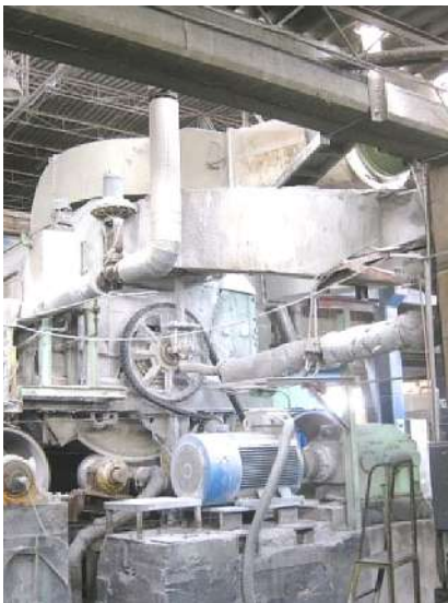
Figura 36. Equipos de tecnología obsoleta
