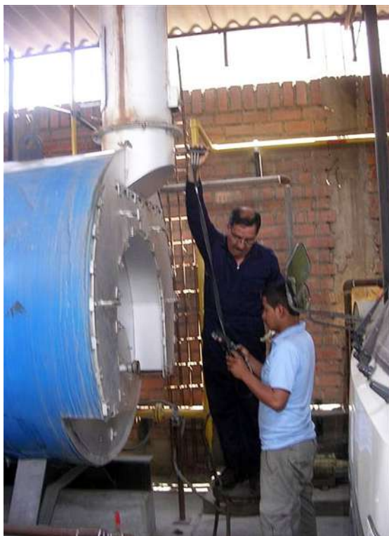
Figura 32. Regulación de la relación aire-combustible al ingreso de la caldera
