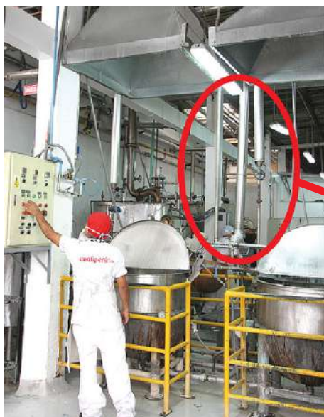
Figura 26. Las tuberías de distribución de vapor
