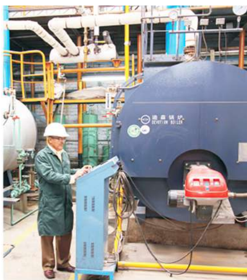
Figura 20. Adquisición de nuevo caldero y aislamiento en redes de distribución de vapor a los diferentes procesos de la planta
